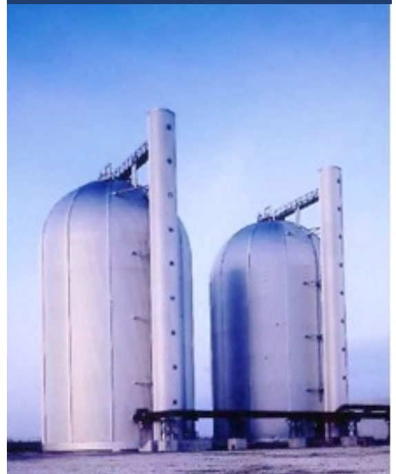
Рис. 5. Пример неведомой для России технологии. Два высокотемпературных аккумулятора тепловой энергии, установленных на ТЭЦ в Копенгагене (фото из журнала News from DBDH )
